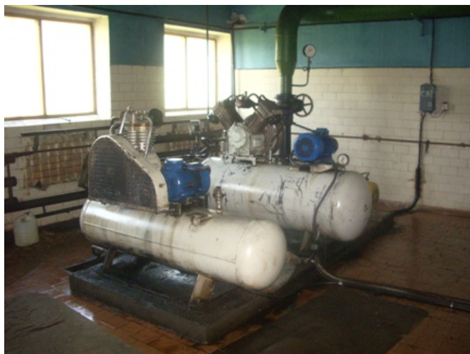
Рис. 11. Компрессорная станция для нагнетания воздуха
